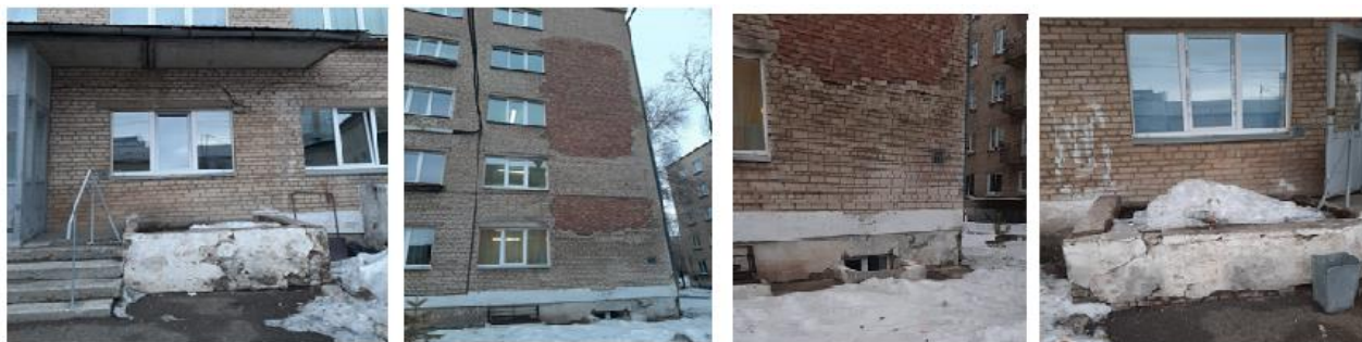
Рис. 1. Дефекты на фасаде
