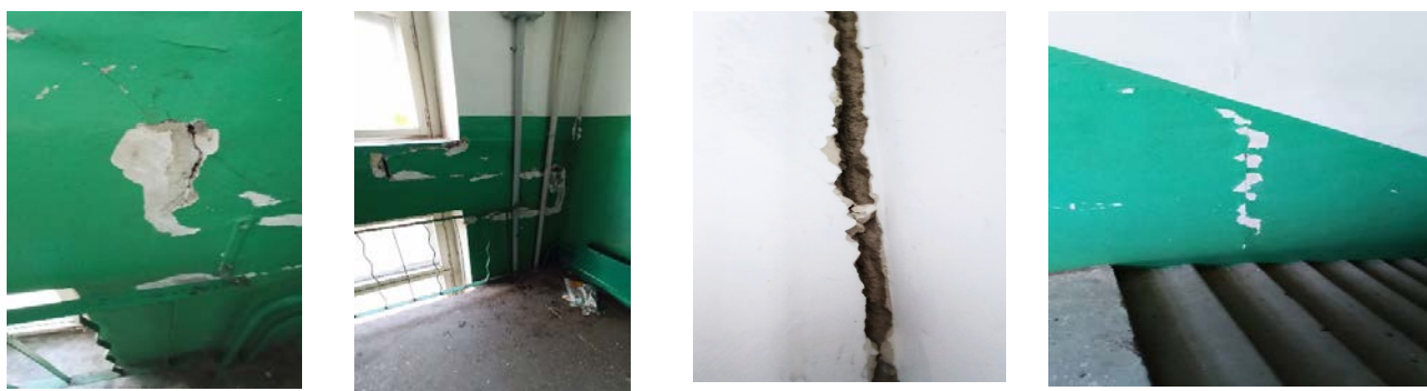
Рис. 1. Выявленные дефекты на исследуемом участке
